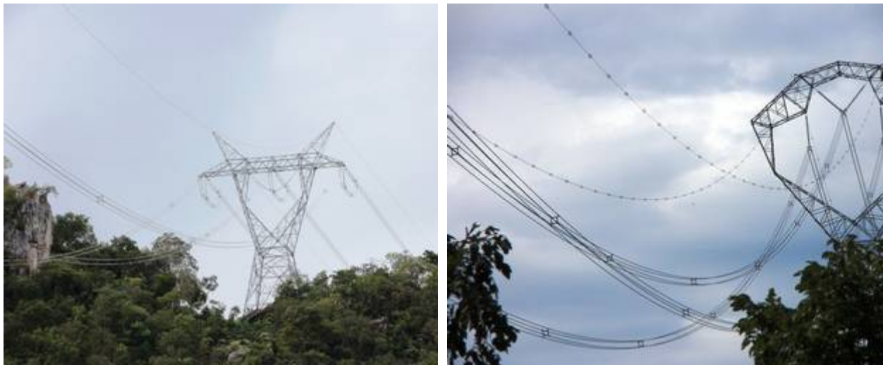
Figura 2 – Torres em meio a vegetação de Cerrado em Colinas do Sul. À direita, cabos para-raios dotados de sinalizadores em espiral.
