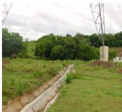
Foto 24 – Dispositivo permanente de drenagem para proteger o pé da torre sobrelevada.
