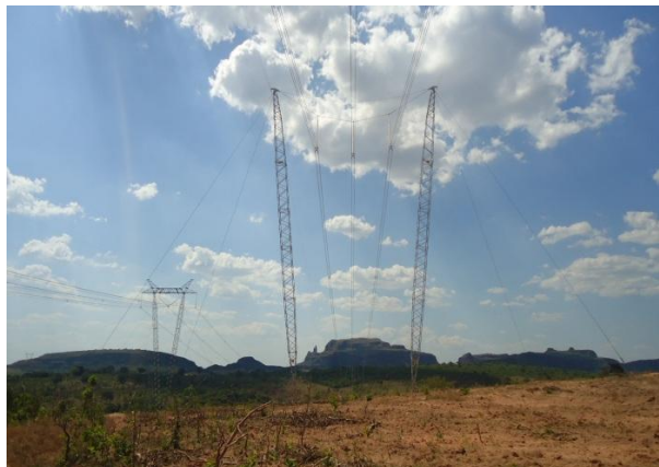
Foto 8.3.3-7 – Futura LT paralela a LTs existentes, em área de pastagem, próxima ao Morro do Gigante, Serra do Caiapó – Fazenda Campo Grande Coord.: 420.606 E / 8.110.222 S
