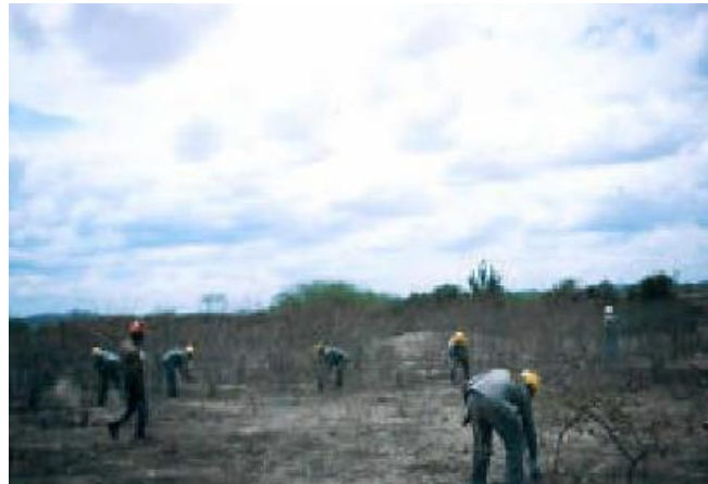
Foto 5 – Limpeza da área de torre com facão, sem uso de maquinaria pesada.
