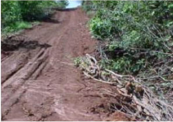
Foto 13 – Necessidade de colocar contenções laterais no corte executado para construir acesso.
