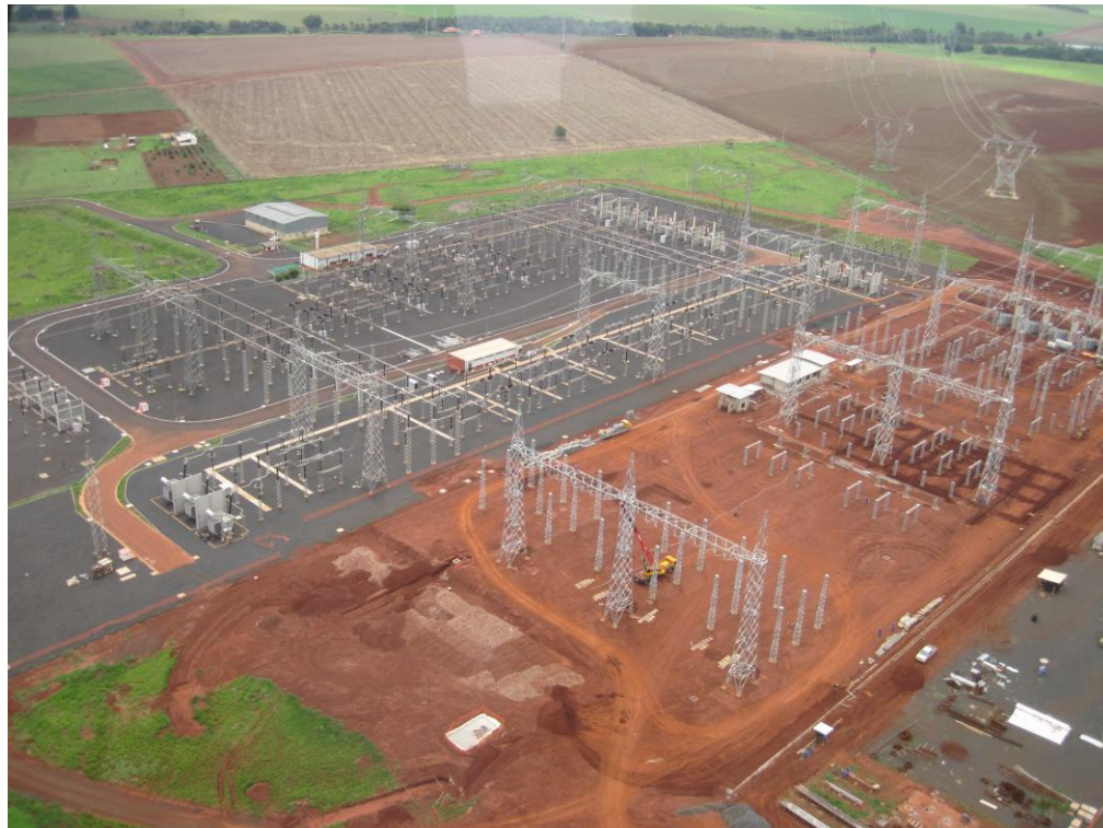
Foto 4 – Vista aérea da SE 500kV Rio Verde Norte, tirada durante a Vistoria Técnica do IBAMA-MG, no período de 19 a 23/11/2012
