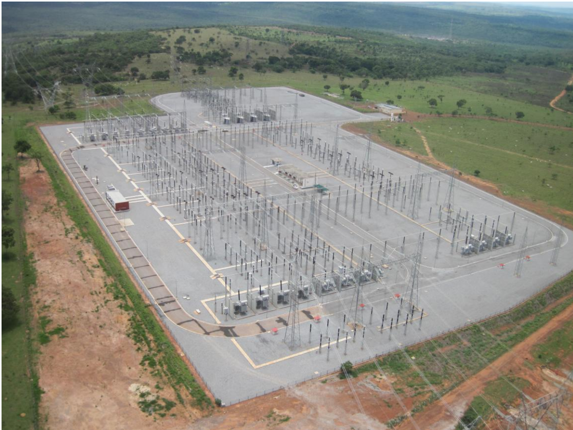
Foto 2 – Vista aérea da SE 230/500kV Ribeirãozinho, tirada durante a Vistoria Técnica do IBAMA-MG, no período de 19 a 23/11/2012
