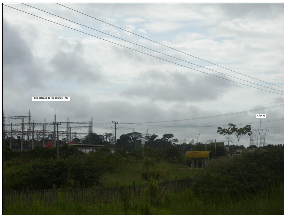
Figura 3.6.5.2-2: Subestação de Rio Branco, AC e LT C1, 2010. Fonte: José Ambrósio Ferreira Neto, abril 2010.
