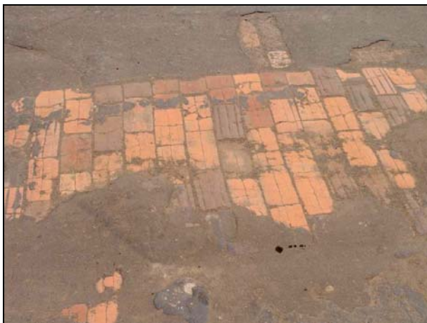
Figura 3.6.3.2.1.1-13: Ruas calçadas com tijolo em razão da ausência de rochas como o gnaiss ou granito. Isto trás para o Estado um custo adicional na manutenção das vias públicas. Fonte: Lani (2008).
