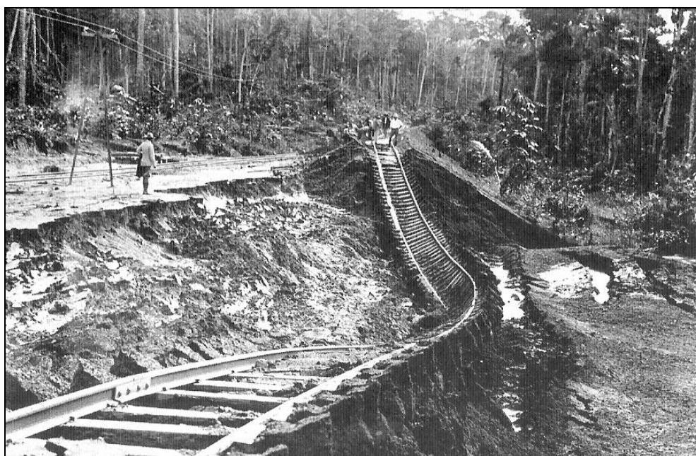
Figura 3.6.5.2.1-5: Deslizamento em trecho da Estrada de Ferro Madeira Mamoré, 1910. Fonte: Hardman, 2005 – Foto de Dana Merrill.
