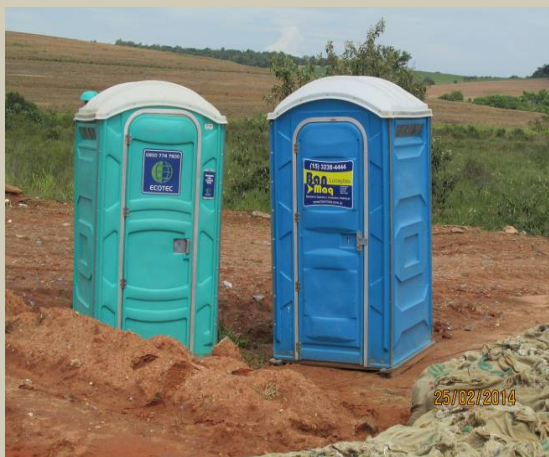
PAC: gestão de efluentes - banheiro químico - condições de trabalho.
