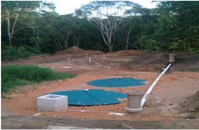
Foto 12-7 – Estação de Tratamento de Líquidos Percolados da MRN, para os efluentes líquidos que sobram do processo de tratamento dos resíduos Fonte: MRN.
