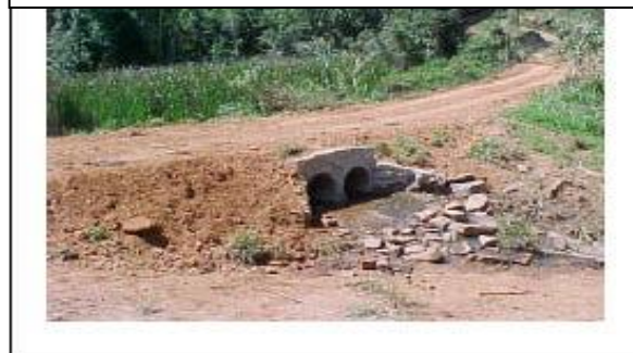
Foto 11-26 – Dispositivos de drenagem nas travessias de córregos.
