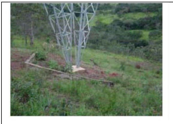
Foto 11-73 – Dispositivo para estabilização do solo e proteção do mastro central da torre.
