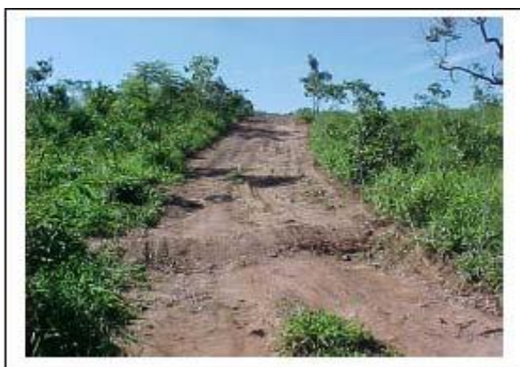
Foto 11-21 – Dispositivos de dissipação para evitar erosão nos acessos.
