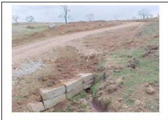
Foto 11-28 – Dispositivos de contenção dos acessos.
