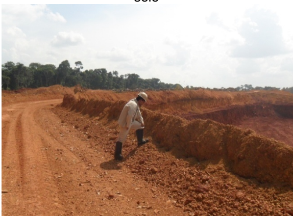
Foto 18 - Verificação de barrancos nas margens da estrada
