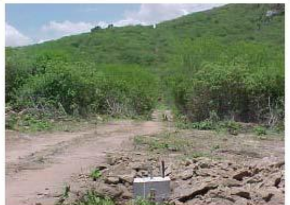
Foto 11-32 – Abertura de faixa com largura de 7 a 10m e o acesso no eixo da LT.
