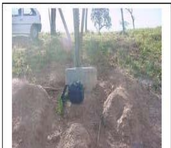
Foto 11-7 – Base de torre com processo erosivo instalado.
