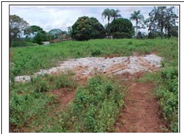
Foto 11-3 – Não conformidade: disposição de restos de concreto no campo.
