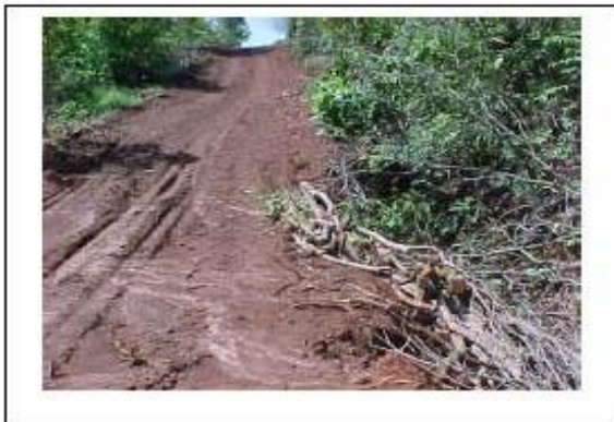
Foto 11-9 – Necessidade de colocar contenções laterais no corte executado para construir o acesso.
