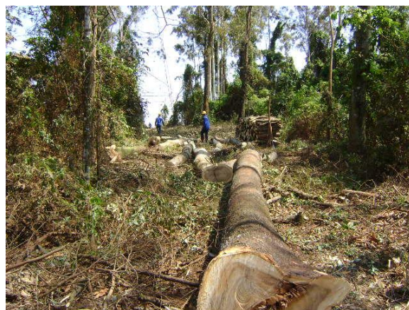
Foto 8-4 – Tombamento adequado de árvores para dentro da faixa de serviço. Fonte: RPTE/BIODINÂMICA, 2009 (outra LT).
