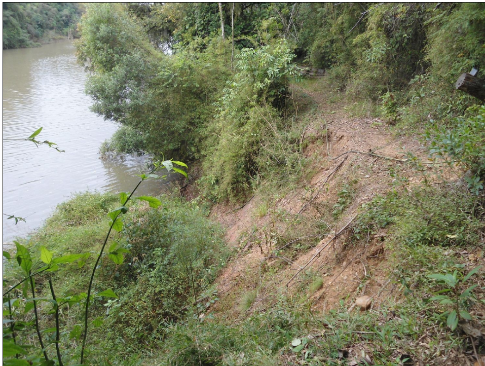
Figura 6.61: Erosão na escarpa do rio Caí.
