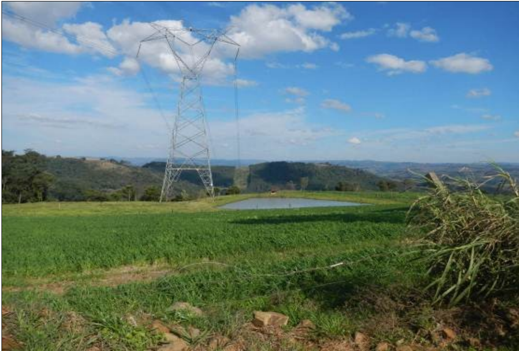
Figura 6.98: Linha de transmissão em funcionamento sobre nascente transformada em açude em meio à lavoura, Itá, SC.
