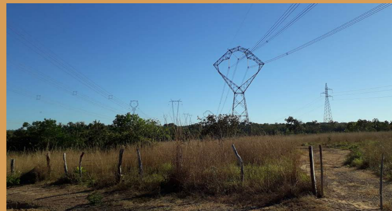
Exemplo de faixa de servidão onde não pode haver casas, culturas altas, canavial e irrigação por pivô central.
