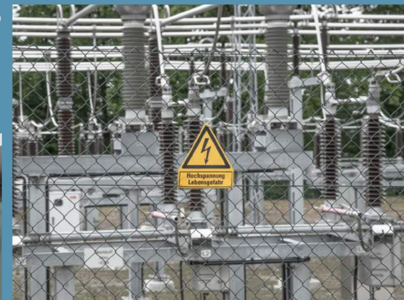
Maquinário Subestação (transformadores)
