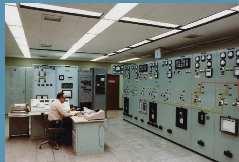
Maquinário Subestação (casa de controle)
