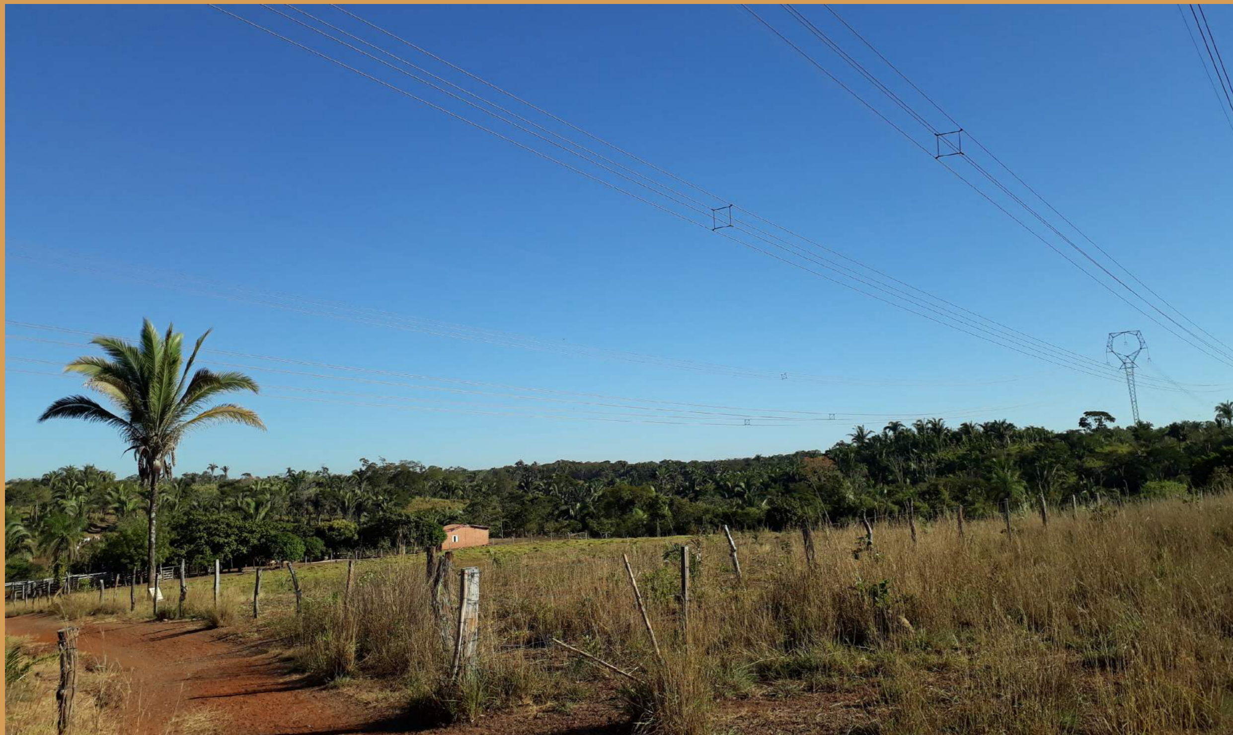
Linha de Transmissão em operação no município de Miracema do Tocantins – TO e residência próxima.
