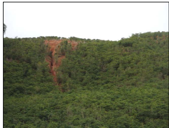
Figura 3.6.3.5-14 - Processos erosivos incisivos instalados nos espessos mantos de solo das encostas das colinas
