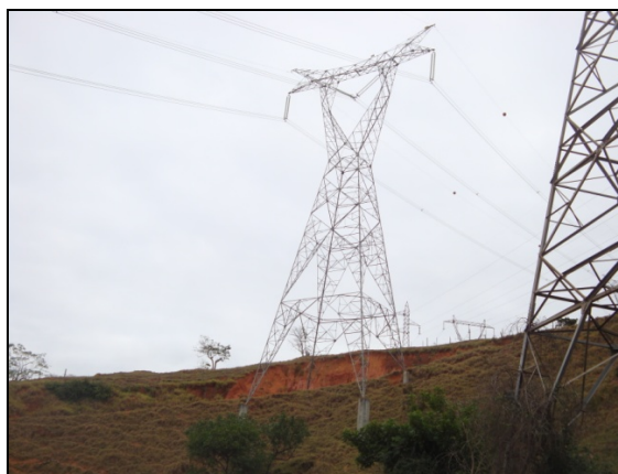
Figura 3.6.3.5-31 - Encostas próximas à SE de Mesquita mostrando um empreendimento semelhante instalado nas encostas com processos erosivos instalados por cortes de estrada (UTM 757105/7851219)
