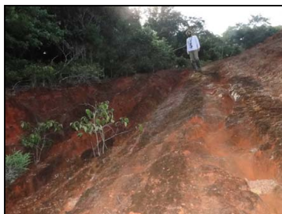
Figura 4-30 - Erosão em ravina em talude de corte da BR-174 (Plintossolo Pétrico) na Serra do Currupira (UTM E 9925783 N 768341, Fuso 20S).
