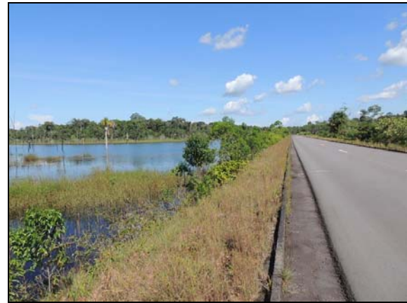
Figura 4-113 - Exemplo de áreas alagadas às margens do trecho da BR-174 compreendido dentro da TI.
