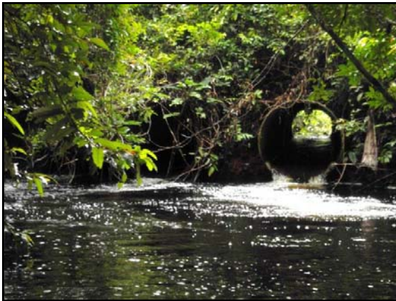
Figura 4-14- Detalhe de bueiro acima da cota do talvegue para passagem da água do Igarapé Kiriri Syná (UTM E 9948087 N 760309, Fuso 20S)
