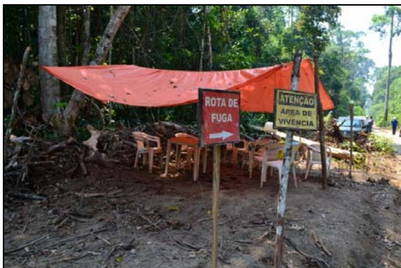
Figura 1-95 - LT CC 600 kV Porto Velho - Araraquara 02, nº 02, área de vivência em área de torre autoportante. 27/09/2013.
