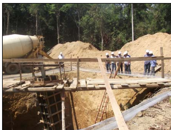
Figura 1-96 - LT CC 600 kV Porto Velho - Araraquara 02, nº 02, área de concretagem fundação de torre autoportante. 27/09/2013.
