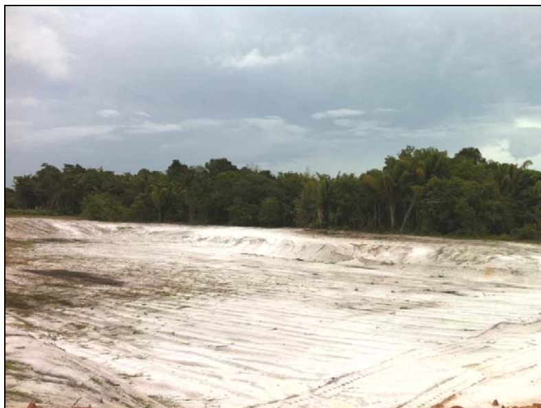
Figura 3.6.3.3-19 - Lavra de exploração de areia na Formação Areias Brancas, ao longo da BR-174 ao sul de Rorainópolis/RR (UTM758086/9995641)
