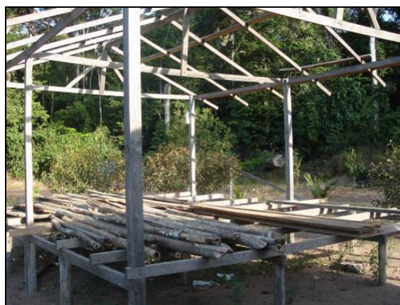
Figura 6.4.8-110 - Casa construída próximo ao Igarapé do Meio.
