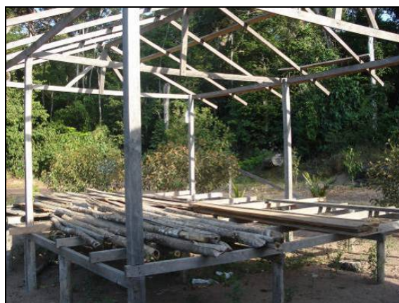
Figura 6.4.8-110 - Casa construída próximo ao Igarapé do Meio.
