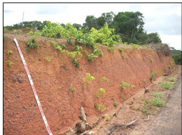
Foto 6 - Corte de estrada com Argissolo Amarelo distrófico pedregoso em subsuperfície, desenvolvido em relevo suave ondulado e plano de colinas amplas (CA) sob vegetação de cerrado. UTM 479070/0025590
