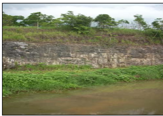
Foto 36 - Pedreira com exploração de calcário. Solo residual sobreposto sobre as rochas calcárias. UTM 831229/9809246
