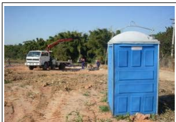
Foto 12-20 – Banheiro químico na praça de serviço.
