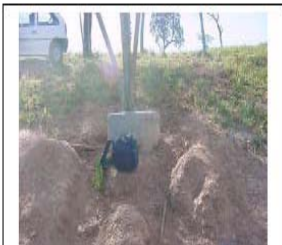
Foto 12-7 – Base de torre com processo erosivo instalado.
