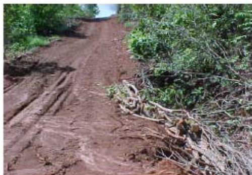
Foto 12-9 – Necessidade de colocar contenções laterais no corte executado para construir o acesso.
