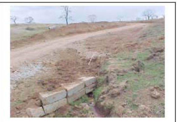
Foto 12-28 – Dispositivos de contenção dos acessos.
