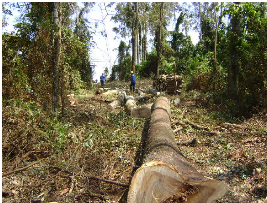
Foto 9-16 – Tombamento adequado de árvores para dentro da faixa de serviço, em outra LT.
