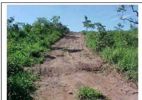
Foto 12-21 – Dispositivos de dissipação para evitar erosão nos acessos.
