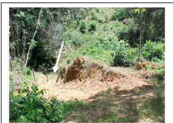
Foto 12-5 – Não conformidade: corte de margem de córrego.
