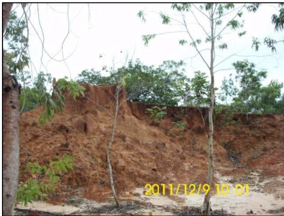
Feição erosiva localizada a 500m da Torre 011/1
