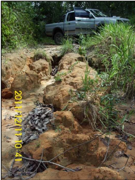
Vista de foco erosivo às margens da estrada de acesso – Ponto 141
