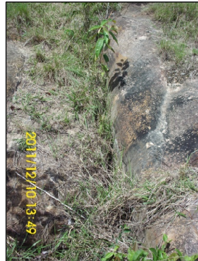
Faturas no maciço próximo ao igarapé Melgacinho
