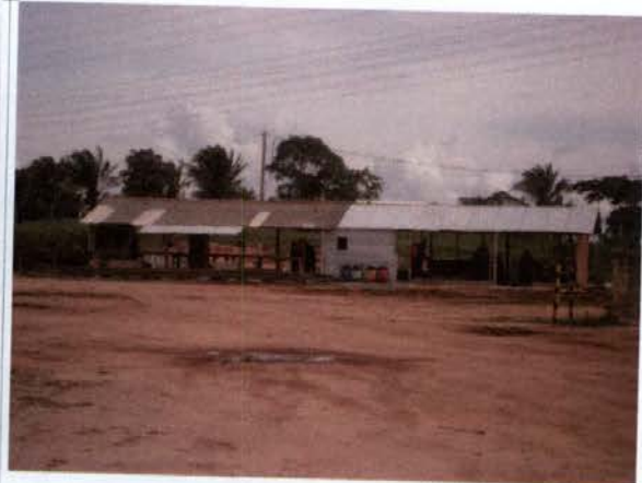
Foto 10 – Central de armação instalada e em funcionamento
