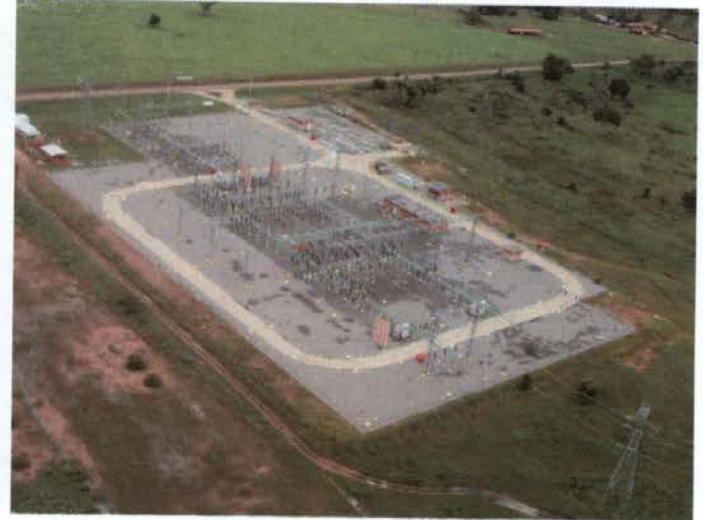
Foto 140: nova vista da SE Pimenta Bueno e entorno imediato.
