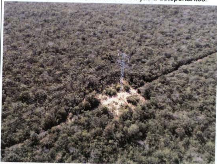
Foto 215: exemplo recorrente na LT existente. Bases de torres desmatadas em toda a área entre os estais, derrubando a tese de menor impacto de supressão em relação a autoportantes.
