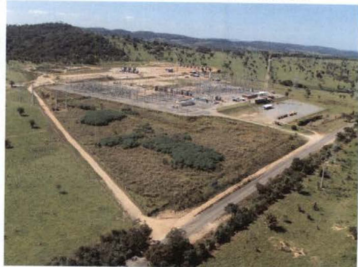
Foto 252: vista aproximada da Subestação Jauru, km 0, na margem da rodovia MT 248 que sai da cidade de Jauru.
