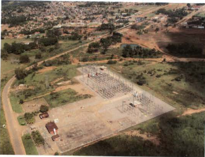
Foto 47: área da SE Ariquemes e condições de vizinhança e proximidade com a mancha urbana.
