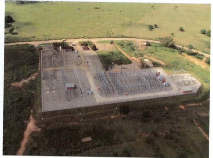
Foto 46: vista aproximada da SE Ariquemes, a margem de avenida que vem da cidade.
