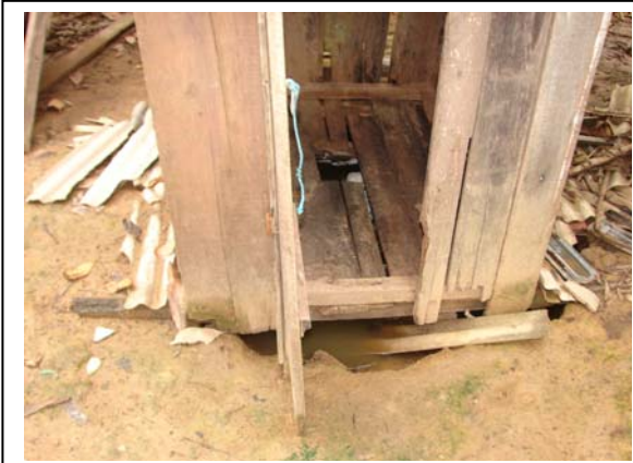
Foto 3.6.5-69: Possível Criadouro artificial localizado no Ponto V15.
