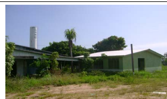
Foto 3.6.5-23 – Posto de Saúde em construção na Vila São Lourenço, em Vilhena (RO). Fonte: Biodinâmica Rio, pesquisa de campo, 2010.
