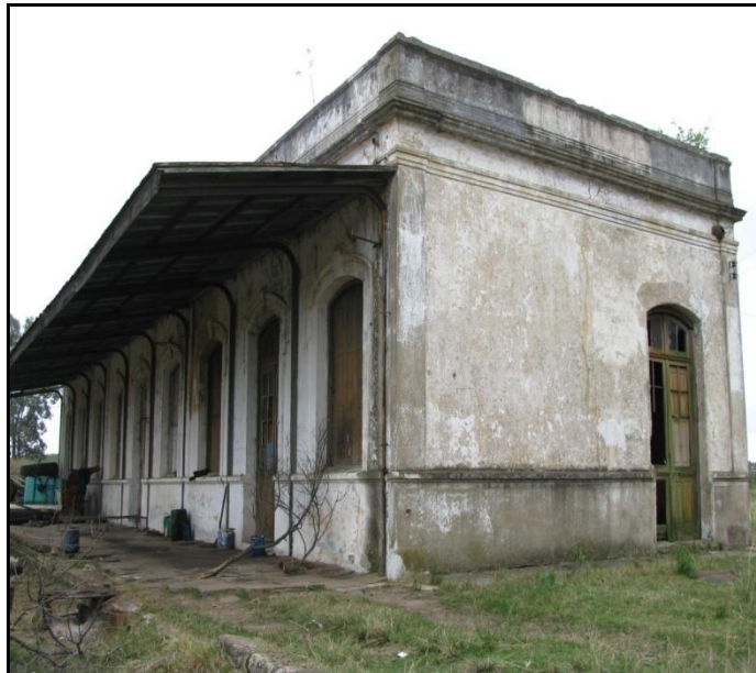
Figura 41: Exemplo de construção com o uso de platibanda, município de Candiota. Antiga estação de trem.
