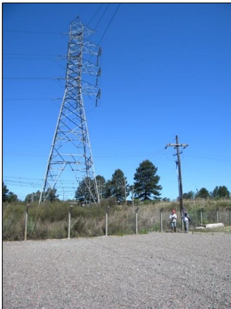
Foto 4: Área da subestação da usina.
