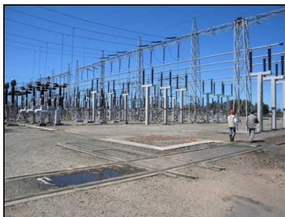
Foto 3: Subestação da usina.
