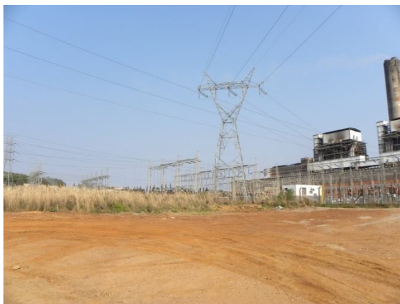
Figura 22. Vista da subestação da UTE Presidente Médici, ponto de partida da LT 230 kV
