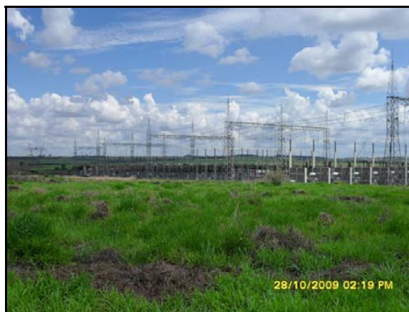
Figura 3.6.5.10-91 - Subestação de Rio Verde
