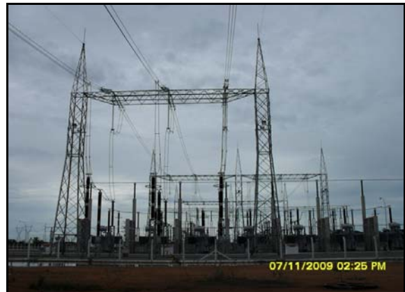
Figura 3.6.5.10-8 - Subestação próxima a Rodovia em área florestada.
