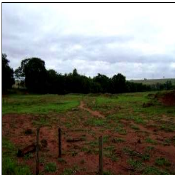
Figura 3.6.3.5-10 - Área de pasto com início de erosão laminar causado por escoamento superficial difuso. UTM: 501424/8043409.
