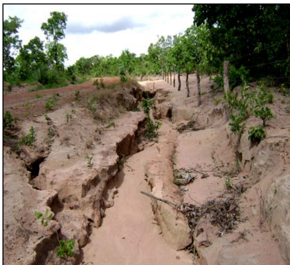
Figura 3.6.3.5-8 - Sulco erosivo orientado pelo escoamento pluvial em estrada vicinal, próximo ao córrego Lajedão. P: 350666/8175959
