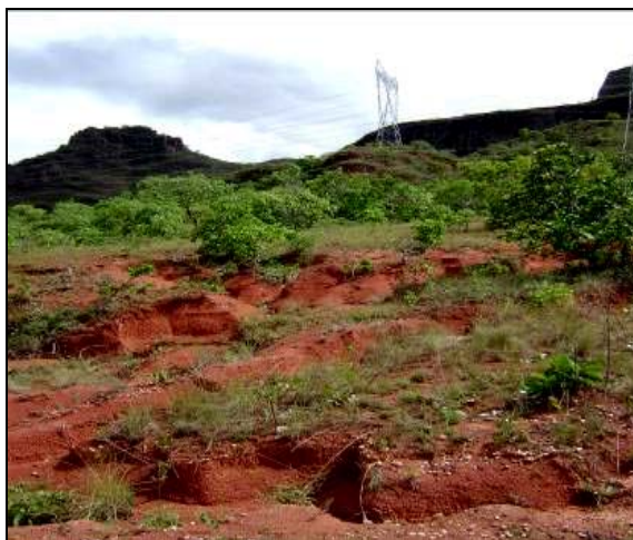
Figura 3.6.3.5-5 - Sulcos erosivos deflagrados pelo pisoteio do gado e fluxo pluvial concentrado, próximos ao complexo da Serra das Torres.
