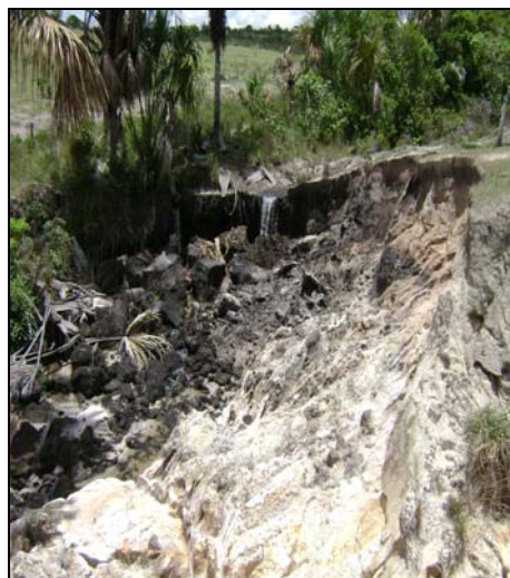
Figura 3.6.3.5-13 - Ravina de aproximadamente 300m de extensão e 70m de largura. Distância de 30m da base da torre já presente (Itumbiara-Cuiabá). UTM: 405937/8126414.
