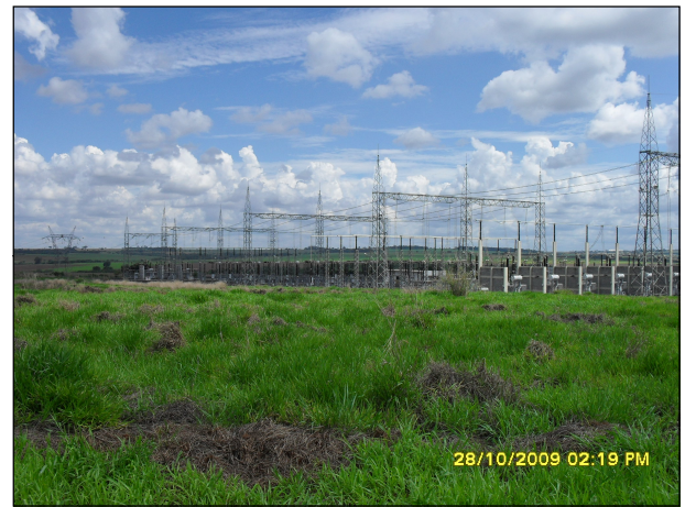
136- Subestação Rio Verde. Acesso pela Fazenda de Jurandir Rodrigues
