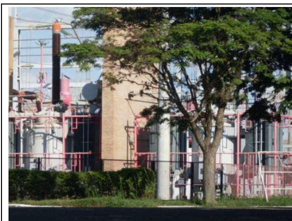
Foto 3.6.5.11-169 - Subestação de Araraquara
