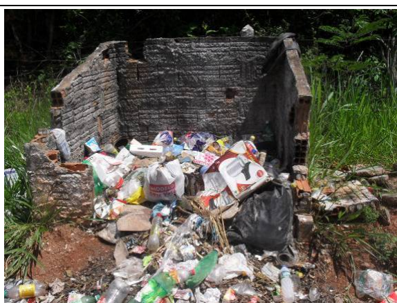
Foto 3.6.5.11-68 - Acúmulo de lixo no interior do distrito
