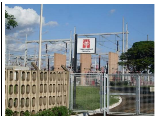
Foto 3.6.5.11-170 - Subestação de Araraquara
