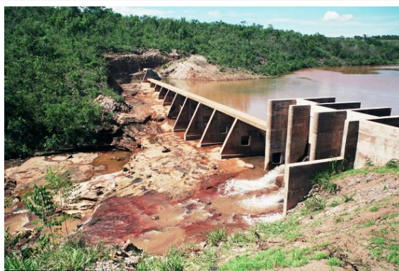
Foto 3.6.3.2-63 - Ponto 126: barragem de PCH no rio Saia Branca, assentada em siltito são micáceo da Formação Ponta Grossa, pouco acima do contato com a Formação Furnas, que aflora no canal de adução da PCH.
