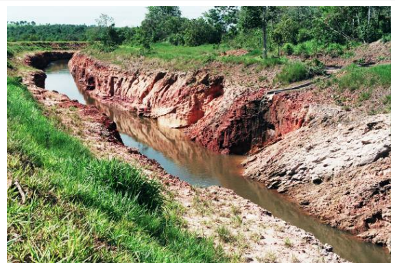
Foto 3.6.3.2-64 - Ponto 126: canal de adução da PCH Saia Branca escavado em arenitos finos a médios, com estratificações cruzadas de pequeno porte, da Formação Furnas.
