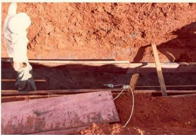
FOTO Nº 7 - Detalhe da confecção do envoltório de carvão, vendo-se as extremidades de duas hastes que serão conectadas entre si na superfície, através dos cabos soldados à sua extremidade.
