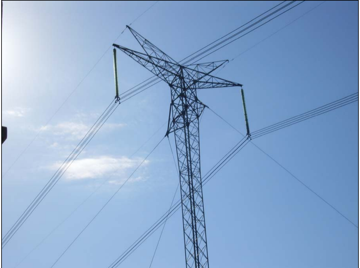
Figura 3.4-11 – Estruturas das torres
