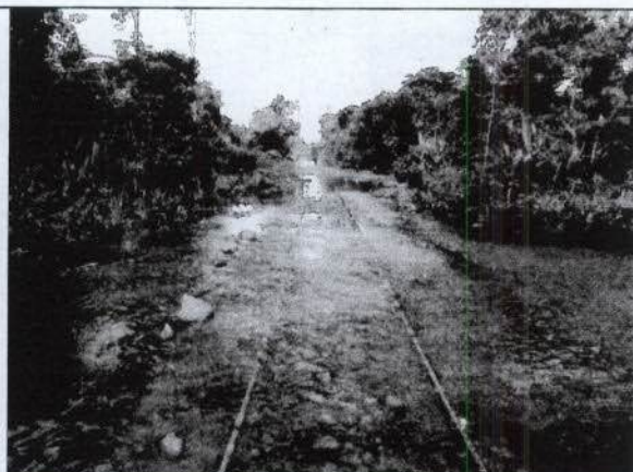
Ilustração 8: Acesso às torres 793-1 e 793-2 – Aterro não autorizado construído na área de inundação do rio Piolhinho. Destaque aos processos erosivos.
