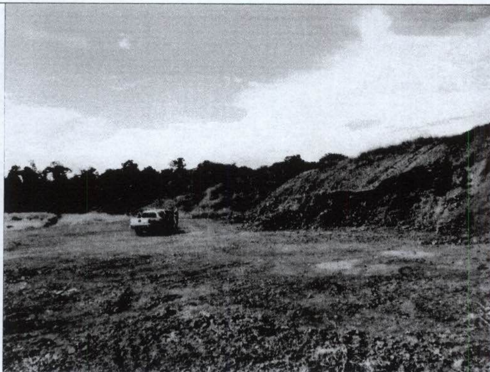
Ilustração 3: Área de empréstimo, sem prévia anuência, utilizada para construção do aterro nas torres 793-1 e 793-2 – Jazida de cascalho.
