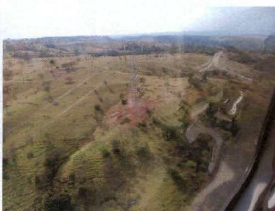
Figura 62: Processos erosivos na base da torre 598/1. Coord. (13° 6'46.18"S 60°45'53.59"O)
