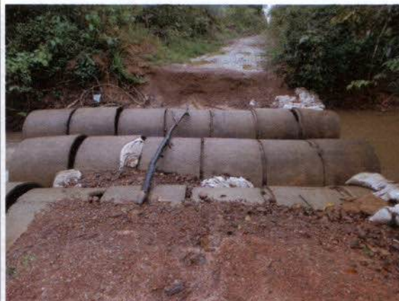
Figura 36: Bueiro subdimensionado. Empreendedor deverá retirá-lo e restaurar o leito do curso d'água. Coord. (15°38'39.57"S 55°48'51.52"O)
