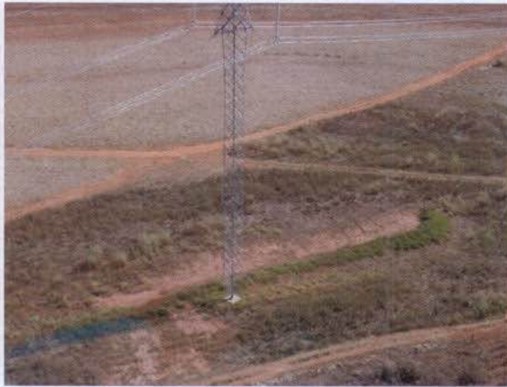
Figura 9: Processos erosivos na base da torre 2402/2. Coord. (20°53'1.42"S 49°48'27.35"O)
