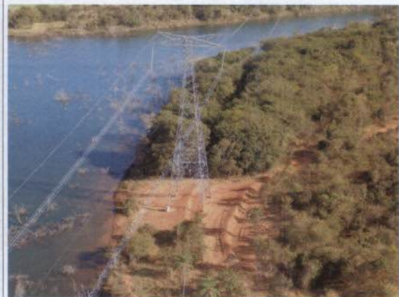
Figura 12: RNC 7-008. Relata carreamento de sedimentos e processos erosivos em 14/03/2014 na torre 2110/2. Aparentemente solucionada. Coord. (18°47'4.23"S 51°16'22.55"O)
