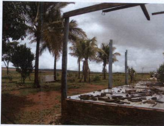
Foto 5 - Edificação próxima a linha, aparentemente abandonada mas não demolida
