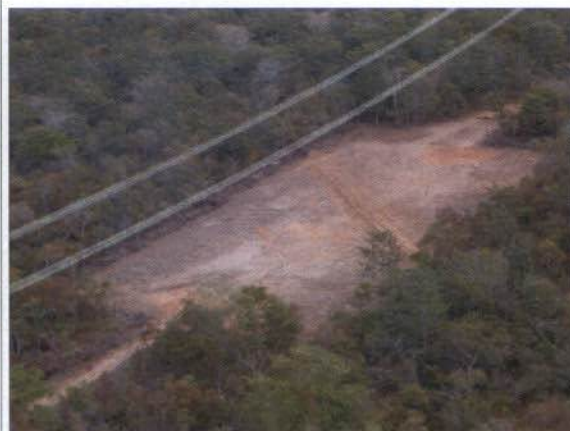
Figura 23: Praça de lançamento de cabos no interior de fragmento florestal no vão entre as torres 1918/1 e 1918/2. Coordenada não registrada.
