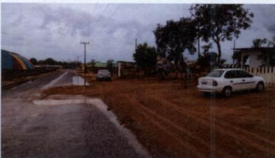
Figura 26: Carreamento de sedimentos para via e ausência de dispositivo lava-rodas no canteiro de Alto Araguaia/MT. Descumprimento condicionante 2.36 item g da L.I nº 855/2012. Coord. (17°19'41.84"S 53°13'30.99"O)
