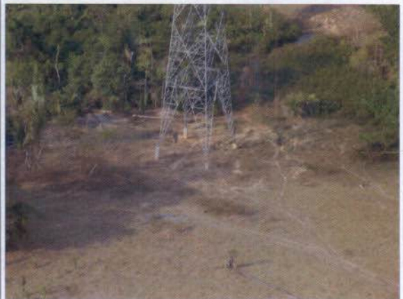
Figura 50: Processos erosivos na base da torre 250/1. Coord. (10°35'57.56"S 62°31'12.14"O)
