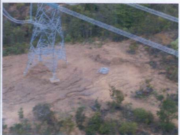
Figura 27: Processos erosivos na base da torre 1761/1. Coord. (17°18'13.75"S 53°33'42.25"O)
