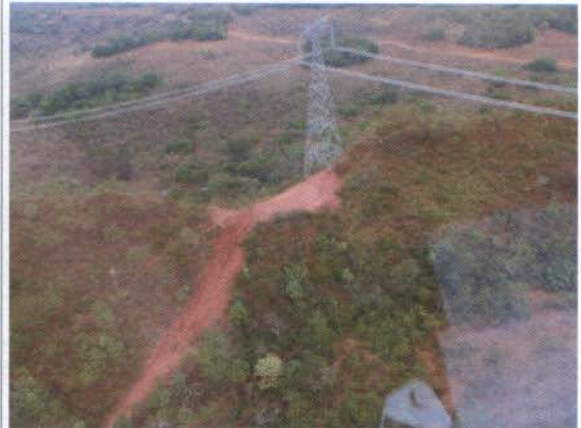
Figura 29: Processos erosivos no acesso à torre 1759/2. Coord. (17°15'36.24"S 53°36'14.08"O)
