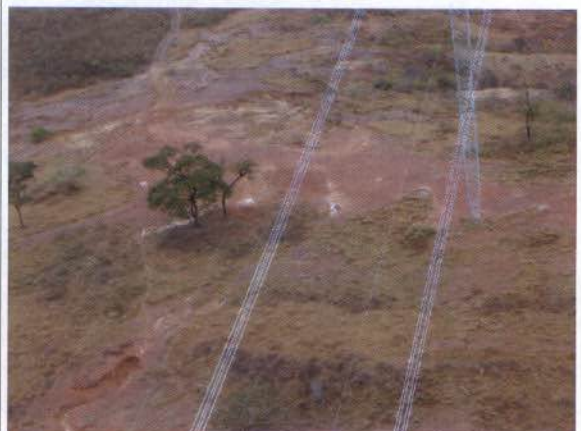
Figura 31: Processos erosivos preexistentes próximos ao acesso e base da torre 1635/1. Coord. (16°27'56.20"S 54°17'53.45"O)
