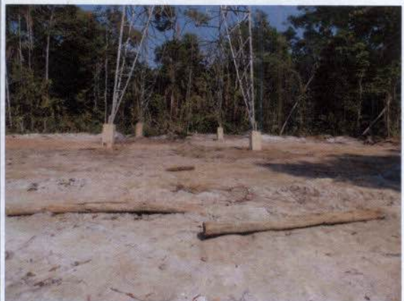
Figura 42: RNC 1-033. Relata lançamento de concreto sobre solo em 18/10/2013 na base da torre 81/2. Solo disposto na torre semelhante a concreto. Coord. (9°27'5.85"S 63°28'59.15"O)
