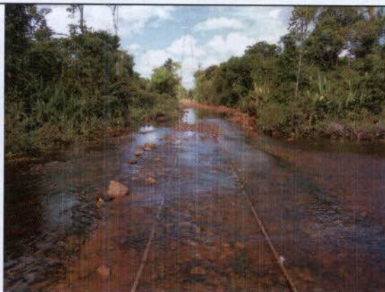
Ilustração 22: Acesso às torres 793-1 e 793-2 – Aterro não autorizado construído na área de inundação do rio Piolhinho. Destaque aos processos erosivos.
