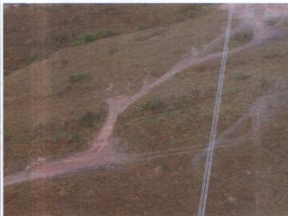
Figura 35: Processo erosivo no acesso a torre 1490/3 e ausência de dispositivos de contenção de escoamento superficial. Coord. (15°50'36.73"S 55°24'24.15"O)
