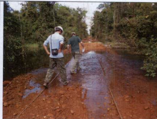
Ilustração 21: Acesso às torres 793-1 e 793-2 – Aterro não autorizado construído na área de inundação do rio Piolhinho, afluente do rio Guaporé. Apresenta 16 pontos submersos, deflagrando processos erosivos e assoreamento do rio.
