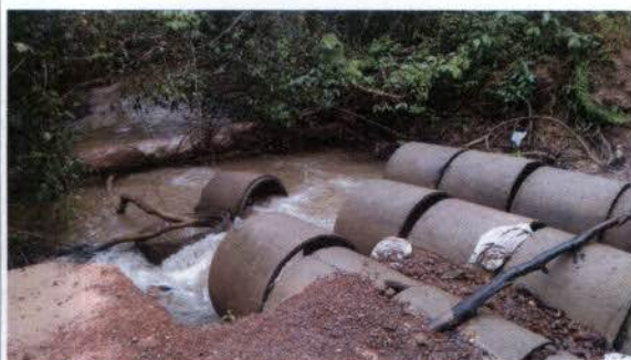
Figura 37: Bueiro subdimensionado. Empreendedor deverá retirá-lo e restaurar o leito do curso d'água. Coord. (15°38'39.57"S 55°48'51.52"O)
