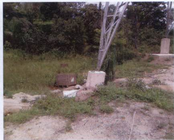
Foto 2 - Resíduos metálicos e caixas de madeira na praça da torre 1466-3
