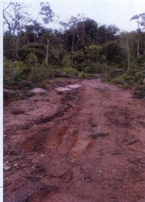
Figura 34: Processo erosivo no acesso a torre 1496/2 e ausência de dispositivos de contenção. Coord. (15°53'5.14"S 55°22'8.76"O)
