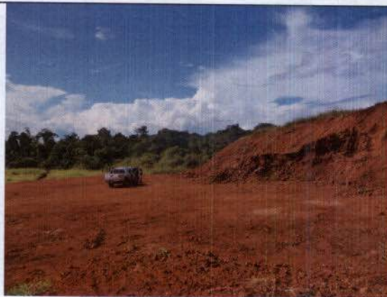
Ilustração 27: Área de empréstimo, sem prévia amenuência, utilizada para construção do aterro nas torres 793-1 e 793-2 – Jazida de cascalho.
