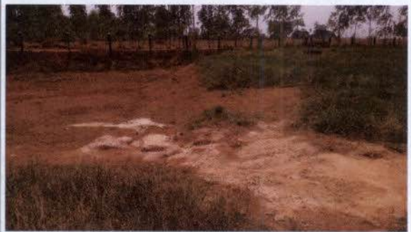
Figura 56: RNC 2-016. Relata, entre outros, lavagem de caminhões betoneira em local inadequado em 01/07/2013 no canteiro de Rolim de Moura/RO. Foi verificado a permanência de resíduo de concreto na área. Coord. (11°41'47.37"S 61°46'52.63"O)
