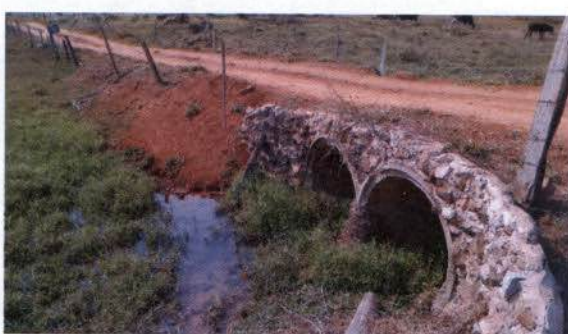
Figura 54: RNC 2-002. Relata, entre outros, instabilidade dos aterros de bueiros em 19/02/2013. Bueiro foi encabeçado a montante e aparentava recente adequação no aterro. Coord. (11° 8'21.39"S 62° 7'42.05"O)
