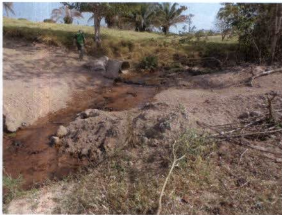
Figura 69: RNC 4-021. Relata problemas em bueiro 14/04/2014. Resíduos das manilhas disposto em APP. Coord. (15°14'14.40"S 58°55'45.51"O)
