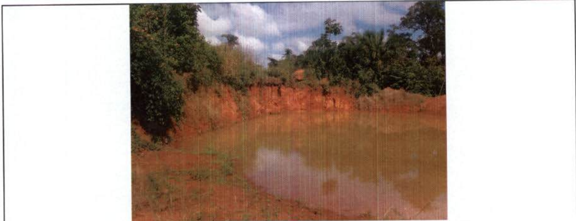
Ilustração 38: Área de empréstimo, sem prévia anuência deste Ibama, utilizada para construção do aterro no trecho entre as torres 961/1 e 961/2.
