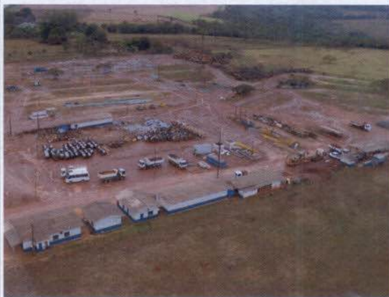
Figura 33: Canteiro de Jaciara/MT. Destaque as bobinas vazias. Empreendedor deverá providenciar destinação adequada. Coord. (15°58'24.82"S 54°56'24.37"O)
