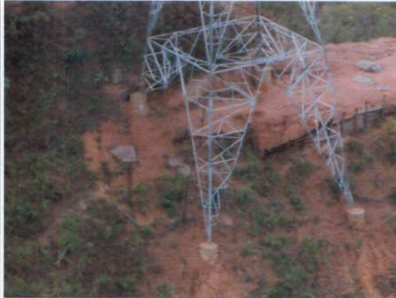
Figura 28: Processos erosivos na base da torre 1.759/2. Detalhe para forte inclinação e precariedade da estrutura de contenção. Coord. (17°15'36.24"S 53°36'14.08"O)
