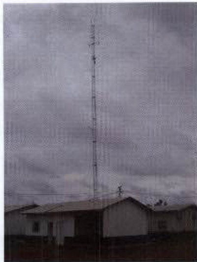
Ilustração 25: Antena de transmissão de sinal de internet instalada no canteiro de obras da IE Madeira, utilizado pela construtora Alta Energia.
