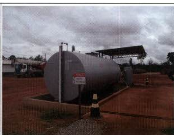
Ilustração 28: Tanque de armazenamento de combustível (óleo diesel) para abastecimento de veículos no canteiro da IE Madeira em Santa Amélia.
