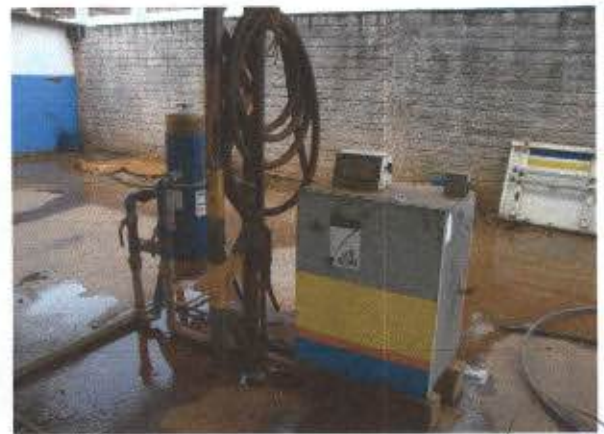
Foto-011- Bomba para abastecimento. Com combustível.
