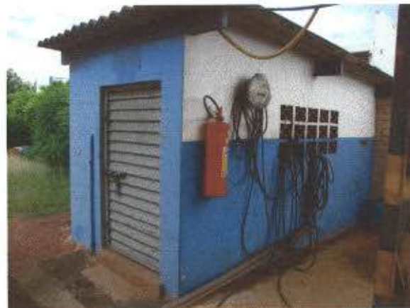
Foto-010- Sala de Maquinas e Calibrador De pneus.
