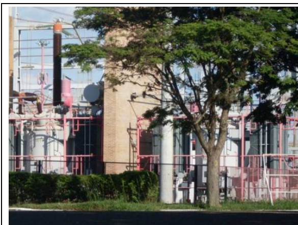
Foto 3.6.5.11-170 - Subestação de Araraquara
