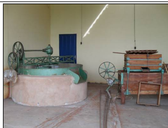
Foto 3.6.5.11-36 - Interior da casa de farinha do assentamento Banco da Terra Canaã.
