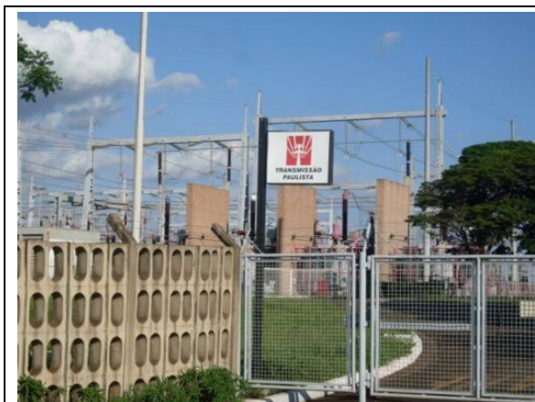
Foto 3.6.5.11-171 - Subestação de Araraquara
