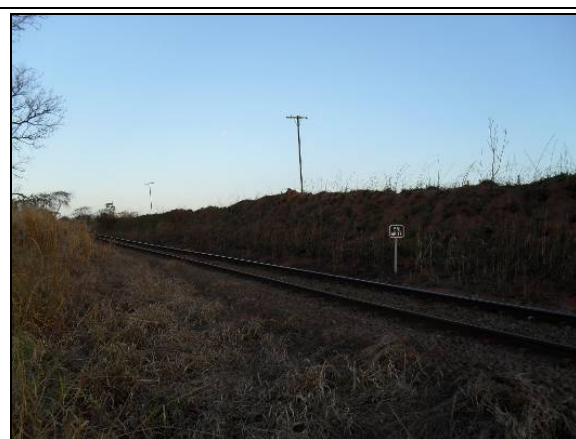
Foto 3.6.5.11-91 - Passagem de nível da Ferrovia que passa na região de Ponto Bom, no município de Fernandópolis.
