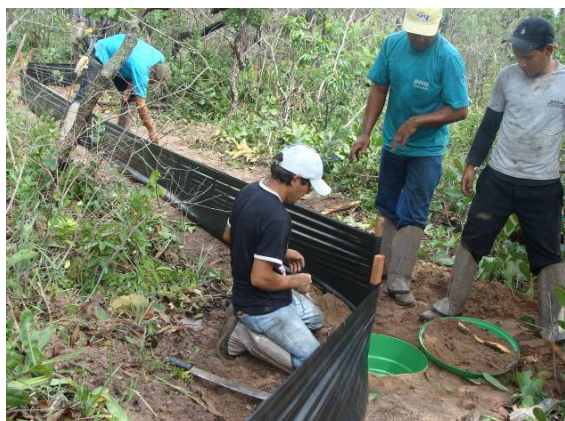
Foto 3.6.4.4-23: Detalhe da equipe de montagem na colocação de da lona plástica e do enterrado.
