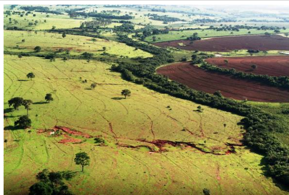
Foto 3.6.3.2-37 - Ponto 433: ravina em que os procedimentos para contenção de erosão não foram suficientes para contenção das águas pluviais; Formação Araçatuba em área de contato com a Formação Serra Geral.
