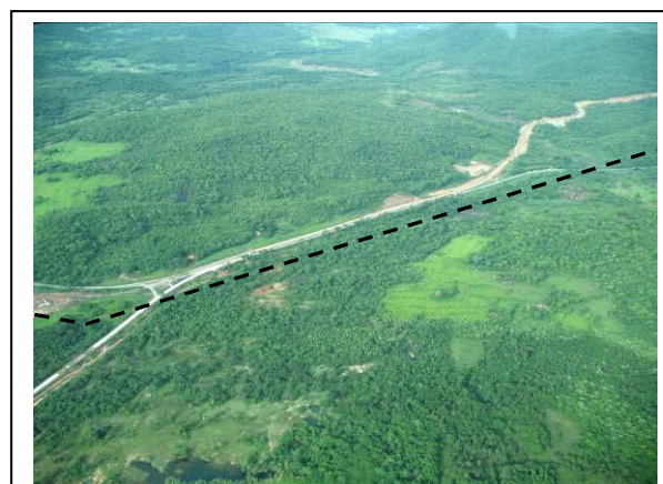
Foto 3.5.2-34 – Trecho da BR-364 na serra de São Vicente/Cuiabá. Trecho em obras de melhorias geométricas na transposição dessa serra.
