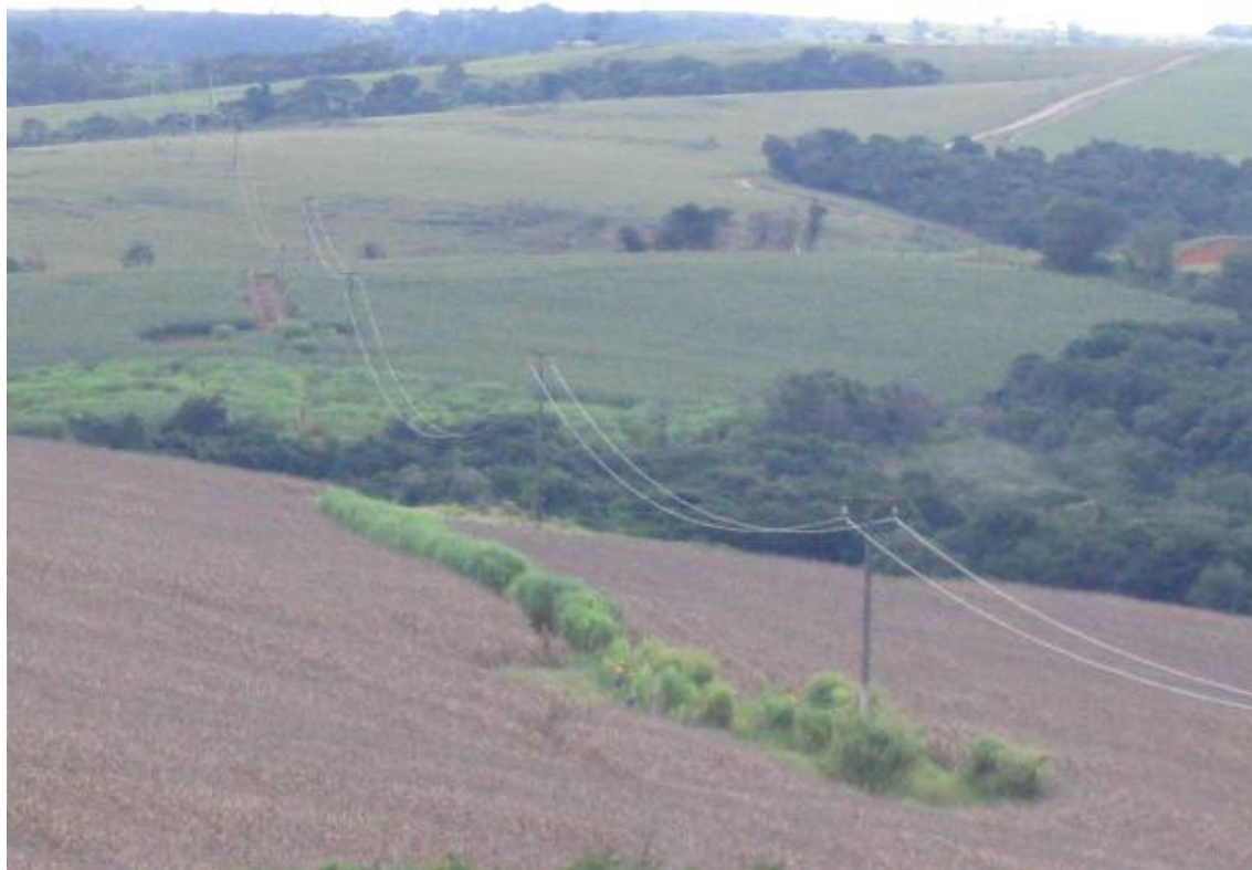
Figura 3.4-25 – Linha de eletrodo instalada nas proximidades da Estação Conversora de Ibiúna - SP
