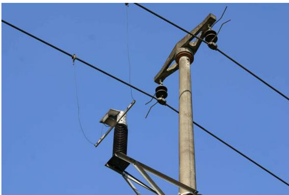
Figura 3.4.-26 – Equipamento de monitoramento “Suplema” instalado na linha do eletrodo da Estação Conversora de Ibiúna – SP
