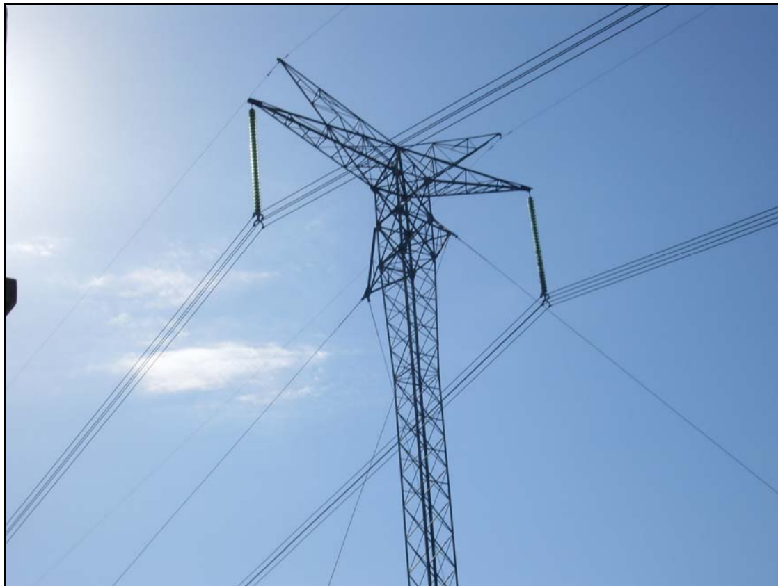
Figura 3.4-11 – Estruturas das torres
