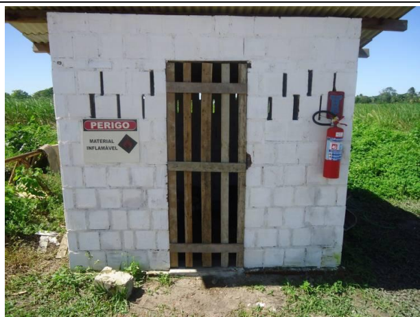
Foto 10.6.1-11 – Baía de armazenamento de produtos inflamáveis (exemplo)
