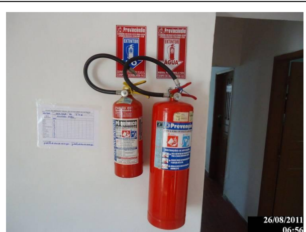
Foto 10.6.1-12 – Sinalização e armazenamento de extintores de incêndio em local de fácil acesso (exemplo)
