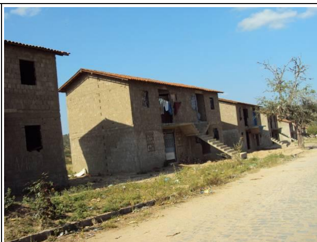
Foto 8.3.3-78 – Casas em construção na AID, no bairro Novo Bodocongó, em Campina Grande
