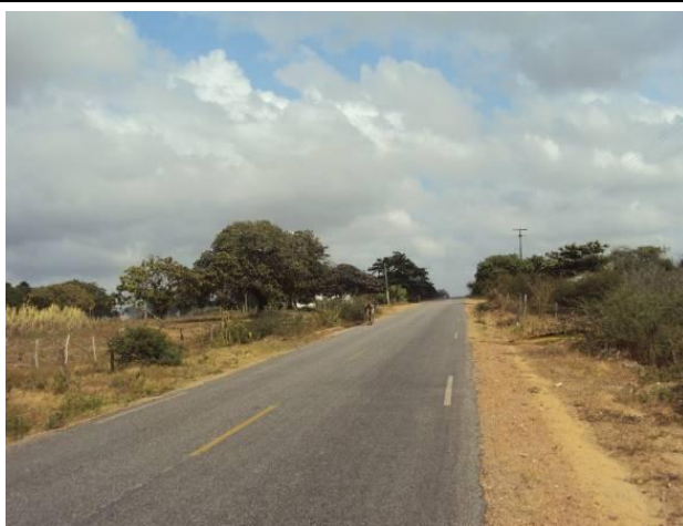
Foto 8.3.3-37 – Cruzamento com a Rodovia RN-120, próximo ao povoado de Nova Aliança, em Serrinha
