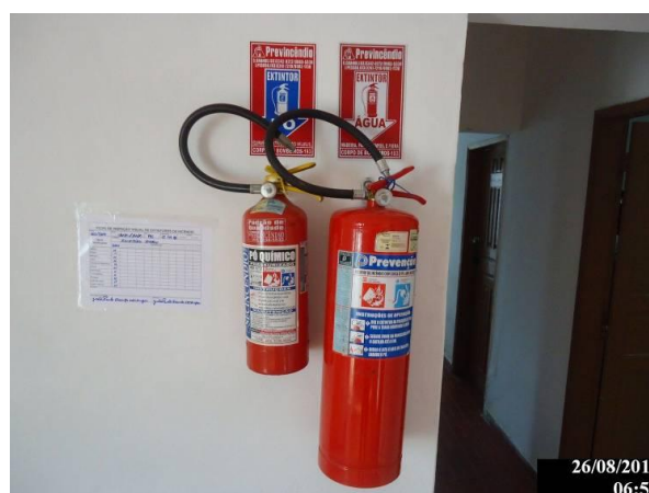
Foto 10.6.1-12 – Sinalização e armazenamento de extintores de incêndio em local de fácil acesso (exemplo)
