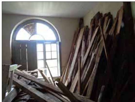
FIGURA 30: SALA DA ESTAÇÃO RIO VERMELHO UTILIZADA COMO DEPÓSITO DE MATERIAIS DA ALL
