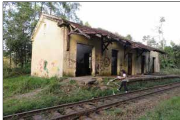
FIGURA 21: PRÉDIO DA ESTAÇÃO RIO NATAL, EM SITUAÇÃO DE ABANDONO
