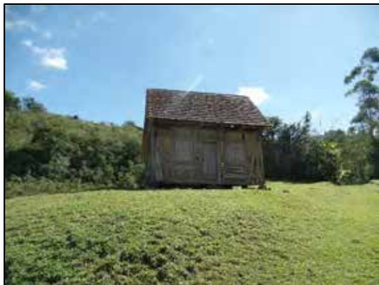
FIGURA 2: CASA ENXAIMEL COM FECHAMENTO EM PAU A PIQUE E TIJOLO MACIÇO (SÍTIO TRIBES)
