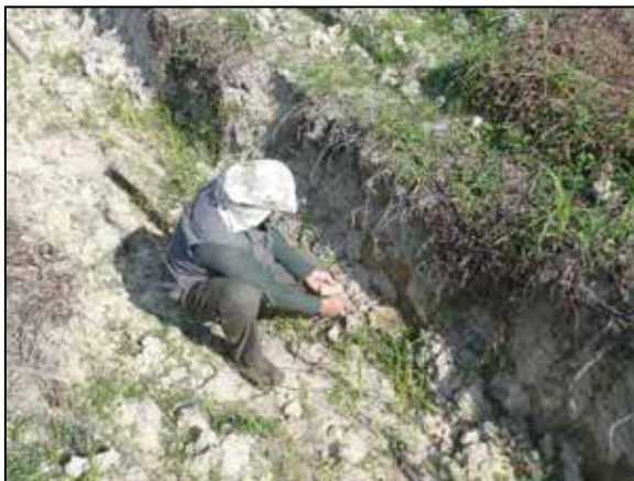
FIGURA 65: ANÁLISE DE MATERIAL ARGILOSO, EM PERFIL EXPOSTO NA AV-26 - COORD. UTM 22J 679943 E, 7074298 N
