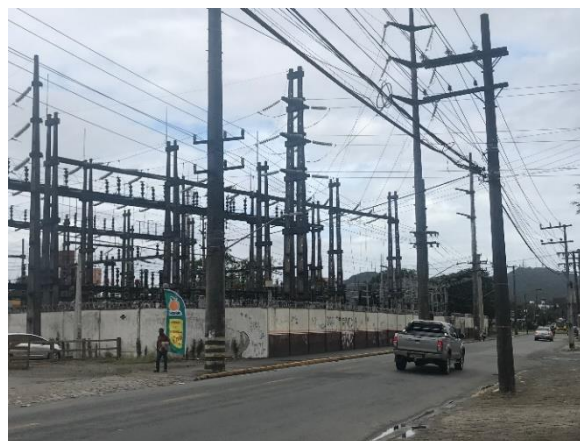
Foto 5.5.3-18: Subestação de distribuição de energia elétrica. Joinville (SC).
