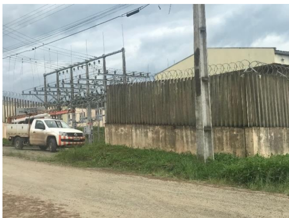
Foto 5.5.3-17: Subestação Paulo Frontin. Paulo Frontin (PR).
