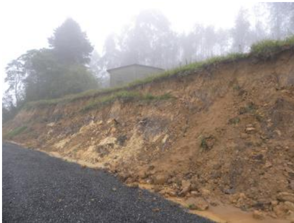
Foto 5.3-77: Vista parcial de talude de corte subvertical, onde ocorreu a mobilização da porção superior do talude, envolvendo massas de cambissolos háplicos presentes no local e rocha saprolítica. Observar os degraus de abatimento, cicatriz do escorregamento e volume acumulado na base, feições típicas deste tipo de instabilização. Registro em talude junto à BR -280, na região da Fazenda Três Irmãos, município de São Bento do Sul/SC. Coord.: 22 J 661180 m E 7087401 m S.
