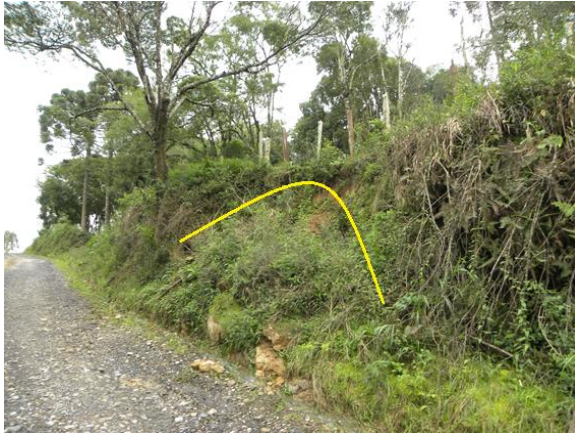
Foto 5.3-74: Massa derivada de escorregamento de material mobilizado em função de movimento de massa, envolvendo parte de talude de corte marginal a via de acesso. No destaque da foto, a cicatriz do movimento; e na porção central, o volume de matéria acumulado no pé do talude. Registro próximo ao arroio Engenheiro Queimado, no acesso a São João, município de Três Barras/SC. Coord.: 22 J 580893 m E 7108742 m S.
