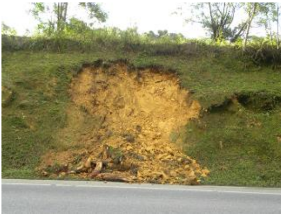
Foto 5.3-72: Detalhe de cicatriz e massa acumulada no pé do escorregamento, envolvendo volume da ordem de 2 m 3 de material saprolítico mobilizado de talude de corte subvertical junto a rodovia BR-280. Instabilidade típica deste padrão de relevo, conforme observado na região do Rio Preto Velho, município de Mafra/SC. Coord.: 22 J 637394 m E 7095208 m S.
