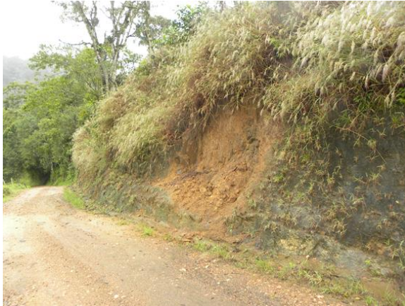
Foto 5.3-69: Detalhe de escorregamento de rocha saprolítica, envolvendo um volume relativamente pequeno de material, instabilizado pelo acúmulo de água no talude e cuja verticalidade do corte, favoreceu o rompimento do material na região de rio Natal, próximo a cachoeira do Kohler, município de São Bento do Sul/SC. Coord.: 22 J 670760 m E 7084658 m S.
