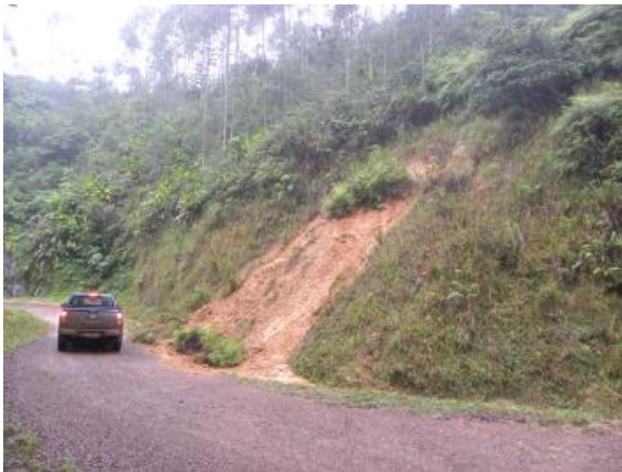
Foto 5.3-81: Detalhe de escorregamento de solo e material saprolítico, envolvendo um volume da ordem de 30 m 3 correlacionado a instabilização de um maciço, em função de corte subvertical, na Serra de Corupano, entorno da via de acesso na região de rio Natal, município de São Bento do Sul/SC. Coord.: 22 J 665676 m E 7084454 m S.
