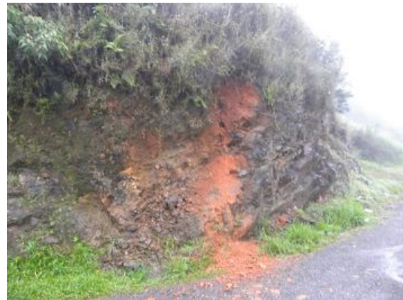
Foto 5.3-78: Detalhe de pequeno escorregamento mobilizando solo no contato solo/rocha saprolítica, presente em talude de corte vertical. A saturação do material superficial e o descalçamento da base de apoio deste material (em função do corte) favoreceram o surgimento do processo. Registro evidenciado em talude junto à BR-280, na região da Fazenda Três Irmãos, município de São Bento do Sul/SC. Coord.: 22 J 660864 m E 7087643 m S.
