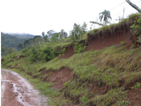
Foto 5.3-86: Detalhe de escorregamento envolvendo um volume de material heterogêneo, onde aparece mobilizado neossolo e rocha basáltica alterada, exposto em talude de corte subvertical ao longo de via de acesso local, na região de Pinhalzinho, município de Cruz Machado/SC. Coord.: 22 J 459010 m E 7132133 m S.
