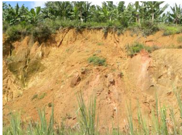
Foto 5.3-53: Detalhe de argissolo vermelho-amarelo em talude de corte. Tipo pedológico que, em situações mais críticas, está sujeito a instabilização, conforme observado no talude, presente nas margens da SC 415, na região de Massaranduba de Baixo, Massaranduba/SC. Coord.: 22 J 706475 m E 7059175 m S.
