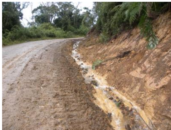
Foto 5.3-83: Caracterização do acúmulo de água na lateral da via de acesso, que, aliada a uma declividade acentuada do terreno, favorece ao processo erosivo sobre rochas areníticas da Formação Botucatu. Na época da fotografia a via passava por uma manutenção, com recuperação do piso e do talude. Registro no acesso a Colônia Santa Helena no município de União da Vitória/PR. Coord.: 22 J 507138 m E 7129776 m S.
