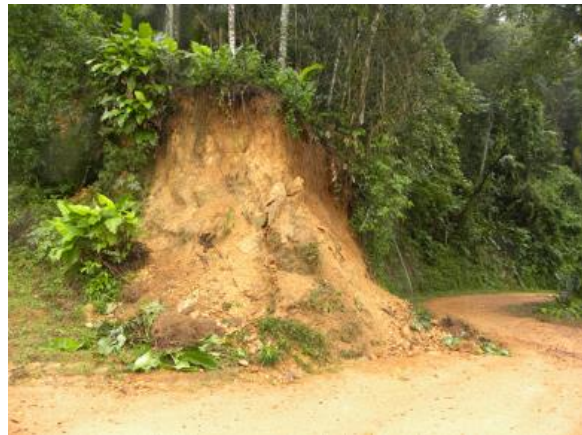
Foto 5.3-82: Detalhe de talude de corte com sinais de instabilização na porção superficial, envolvendo pequeno volume de cambissolo presente no local (cerca de 0,5 m 3 ), decorrente da saturação do material e perda de suporte da porção basal, associado à verticalidade do talude na via de acesso, registrado na região de rio Natal, município de São Bento do Sul/SC. Coord.: 22 J 667203 m E 7084628 m S.
