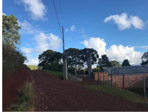
Foto 5.5.4-62: Sistema de eletrificação rural na comunidade Lajeado Feio
