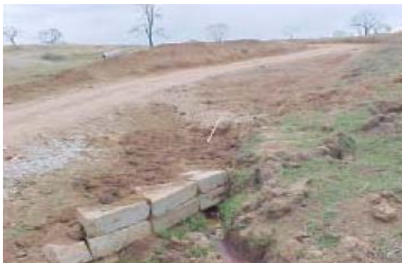
Foto 15 – Dispositivos de contenção de acessos.
