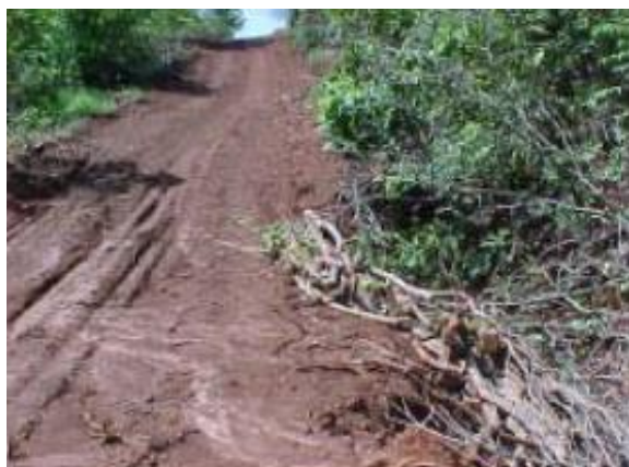
Foto 13 – Necessidade de colocar contenções laterais no corte executado para construir acesso.
