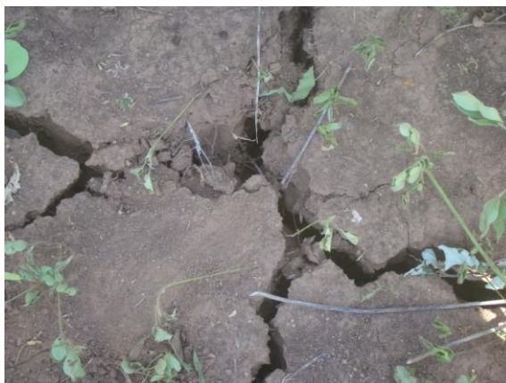
Figura 17 - Aspecto da contração das argilas no ATE-61 (Fonte: Bourscheid, abril/2013).
