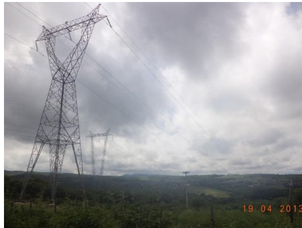
Figura 7.4-102 - Linha de Transmissão de entre Oitis e Catolé (Coordenadas: S07°16'11.2"/W038°52'53.8") (Fonte: Bourscheid, abril/2013).
