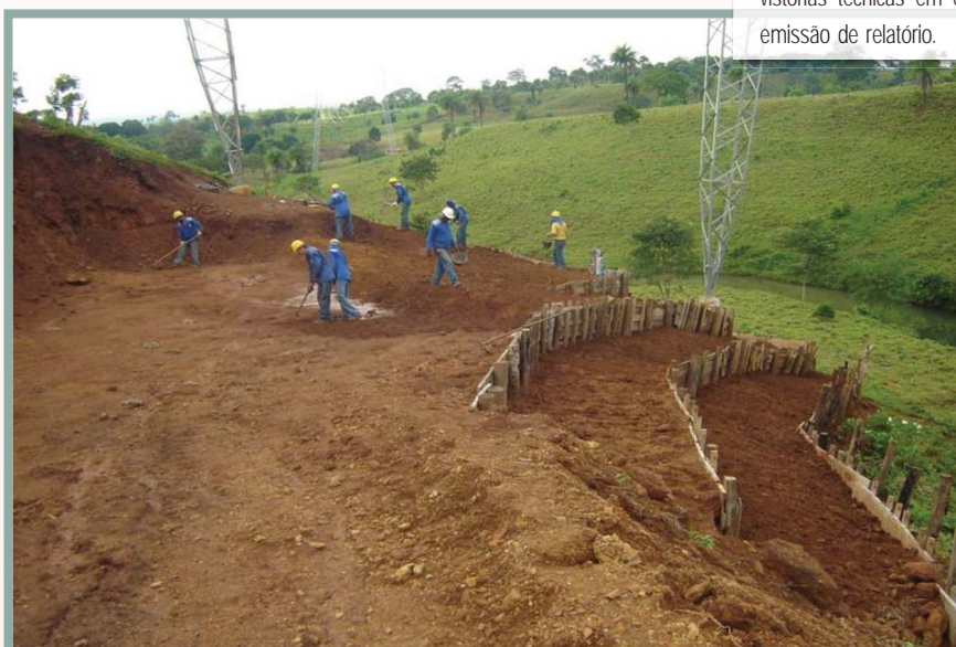
Trabalhadores reconformando taludes na base de torre, para prevenir e controlar processos erosivos
