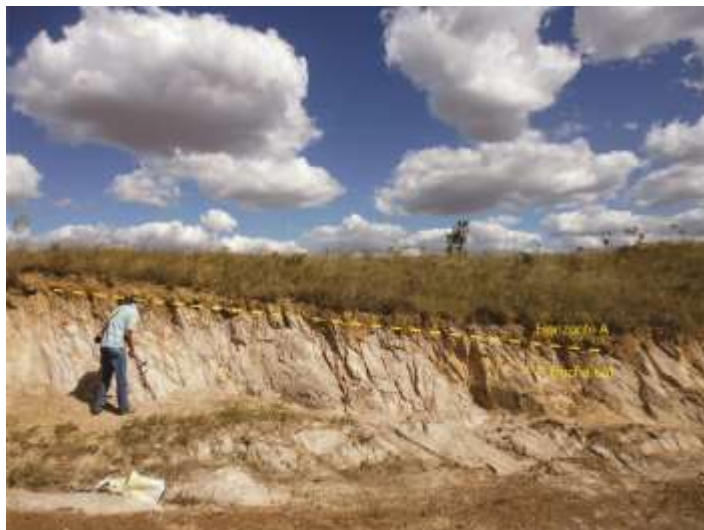
Figura 51 - Corte em estrada vicinal de Neossolo Litólico, ao qual fica evidente o baixo desenvolvimento do solo em trecho onde a erosão tornou o corte instável (UTM Fuso 23K 211.554E / 8.223.894L – 907m)
