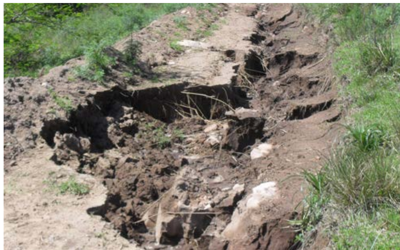
Processo erosivo. Fonte: Bourscheid, 2014.
