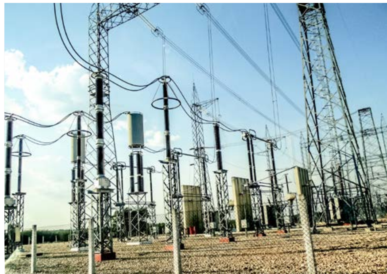
Subestação Miracema, Miracema do Tocantins/TO. Fonte: Bourscheid, 2014.
